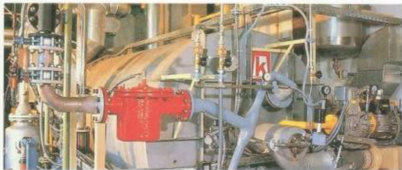
Thermische Abluftreinigungsanlage Thermal incineration system
